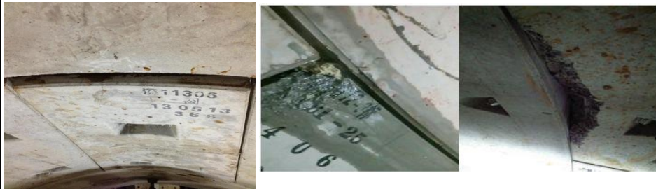
管片上浮、错台、渗漏
